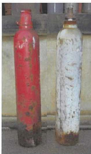
腐食が著しく進行し破裂のおそれのある高圧ガス容器
